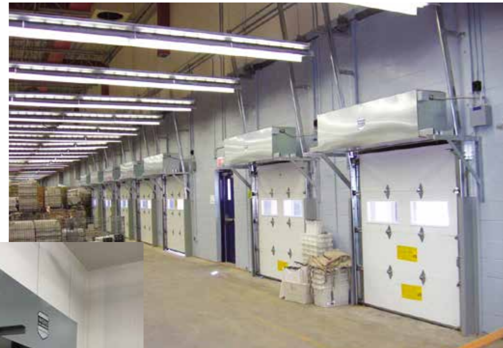
Luftbarrieren verhindern den Austritt warmer Luft im Winter und klimatisierter Luft im Sommer
